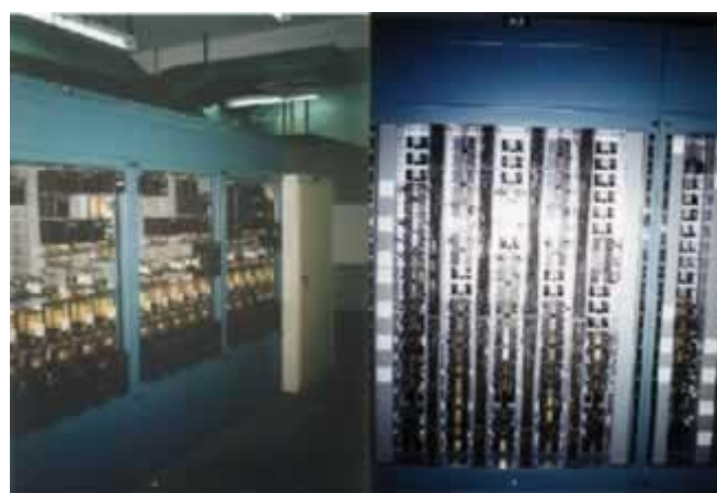
Figura 1. 6 Bastidores con relevadores
